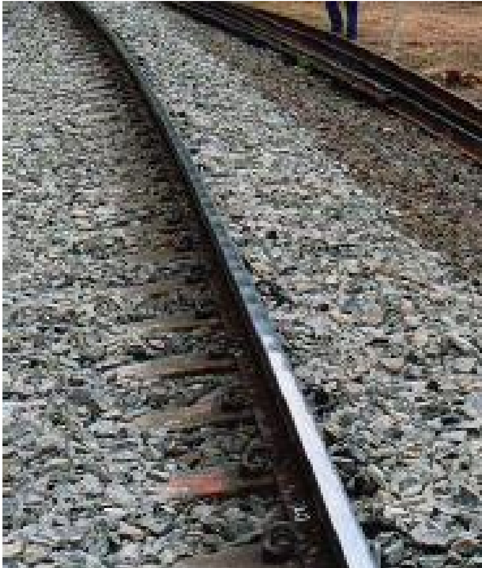
Fig. 3.12 – Corrugação Fonte: Marich Heavy haul
