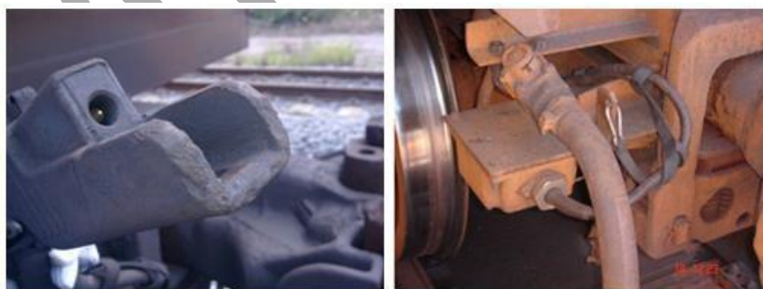
Figura 6: – Conector desgastado (esquerda), e posição segura (direita)
