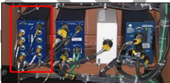
Figura 6: Painel ESW – Roteador da rede de dados
