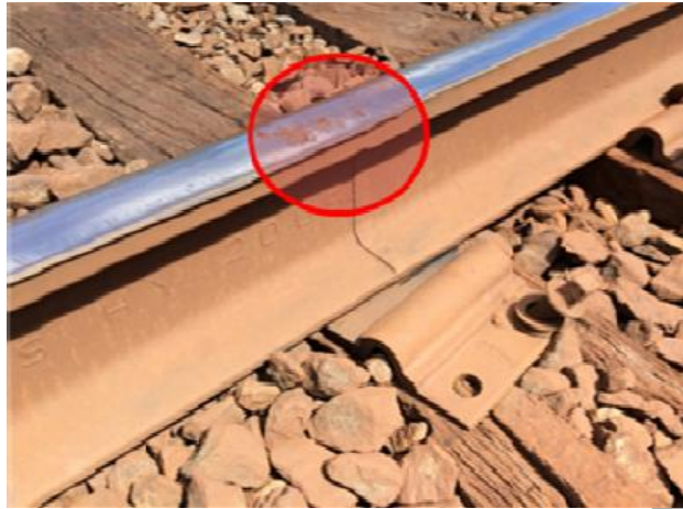
Figura 1: Impacto do defeito superficial sobre a superestrutura
