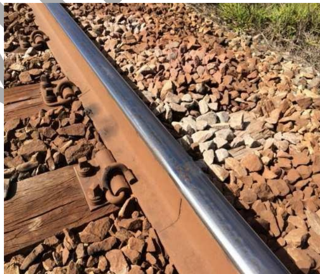
Figura 7: Defeito superficial leve
