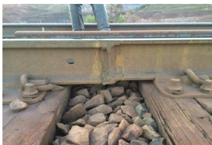
Figura 8: Defeito superficial leve
