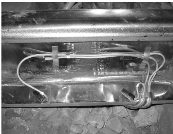
Figura 8: Strain-gauges instalados em trilho para leitura de forças vertical e horizontal
